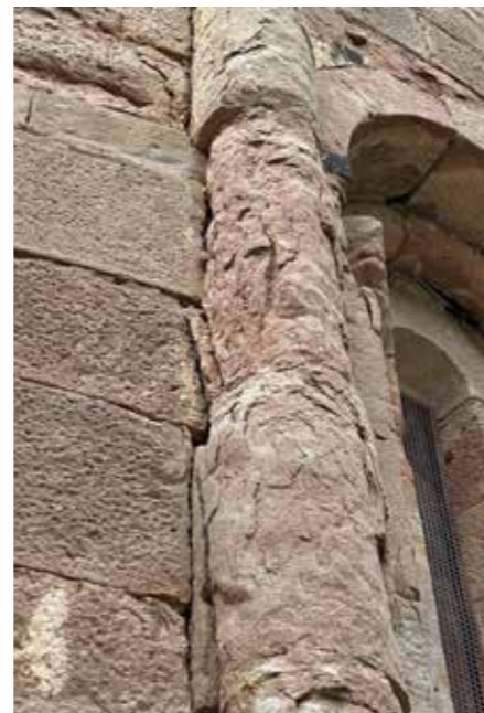
Exfoliació, deplacació, esquerdes, fissures. Imatge: 4restaure S.L.
